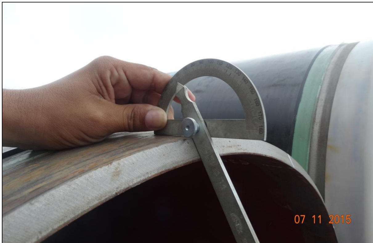
Acopio base de Ticumpinía, midiendo el ángulo de bisel de tubería de 32"Ø.
