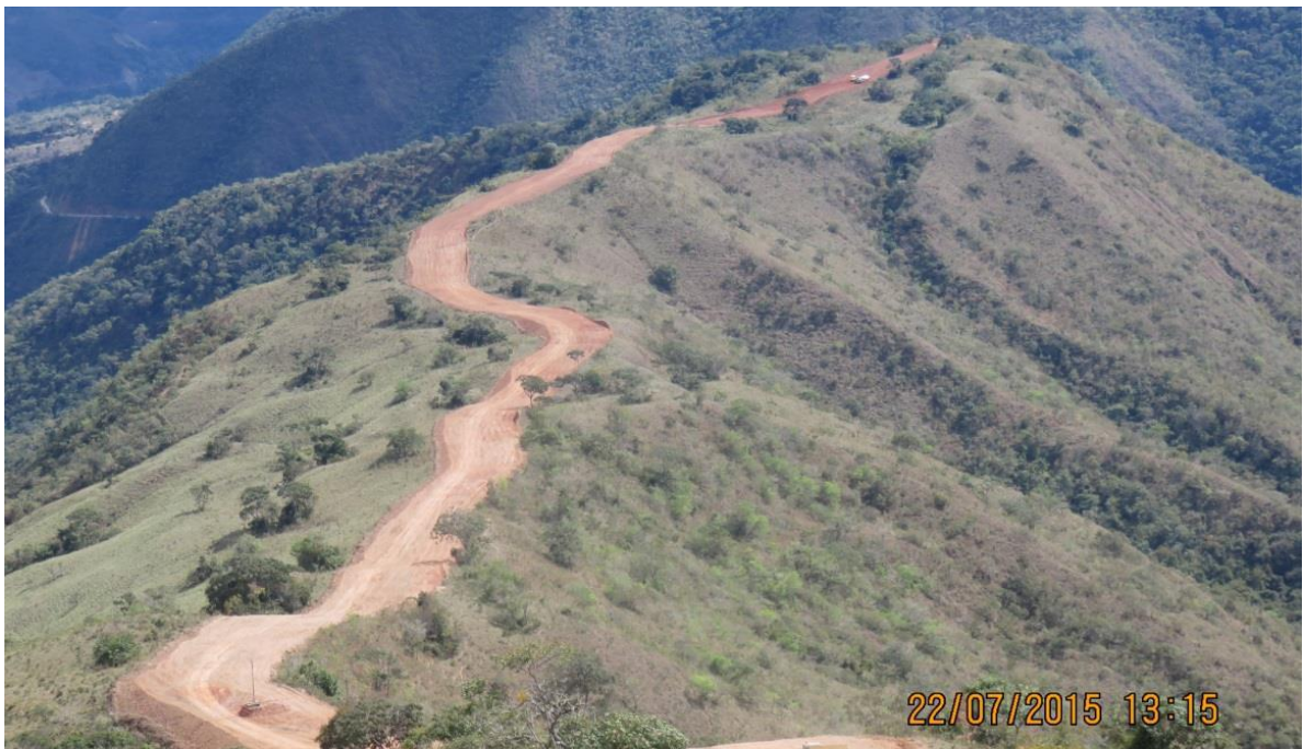
Foto 02: Vista panorámica de los trabajos de Apertura y Nivelación del DDV del tramo 130+200 al KP 132+500, emplazado por la línea de cumbres.
