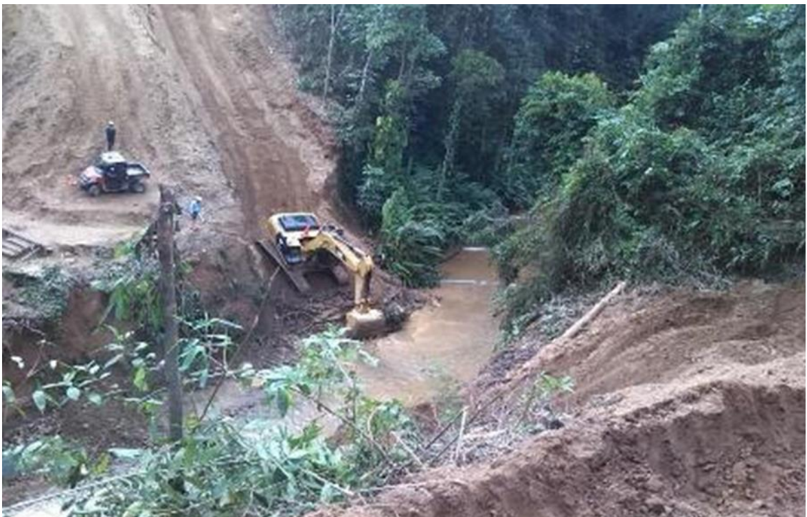
Foto 10: Corte de terreno para rebajar rasante en pendiente del DDV, KP 11+860 al KP 11+900
