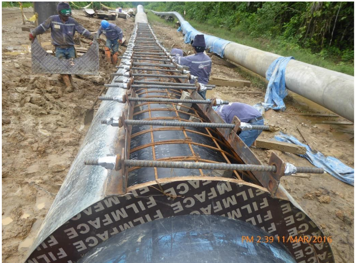
Tramo B-Segmento 1, KP 6+800. Trabajos de concretado de la tubería para el cruce de cuerpos de agua.
