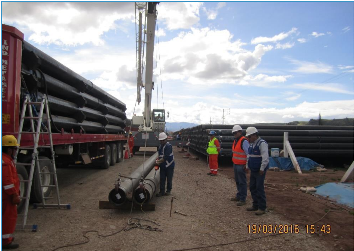
Tramo B-Segmento 1, Acopio de Anta - KP 53+000. Verificación de revestimiento de los tubos de 14"Ø.
