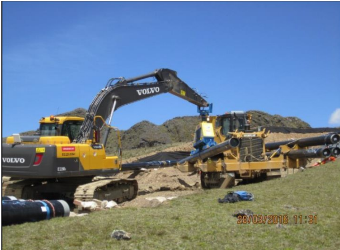
Gasoducto Secundario Cusco Anta, KP-0007+217, Colocación de un tubo de 14" sobre el pipe carrier.
