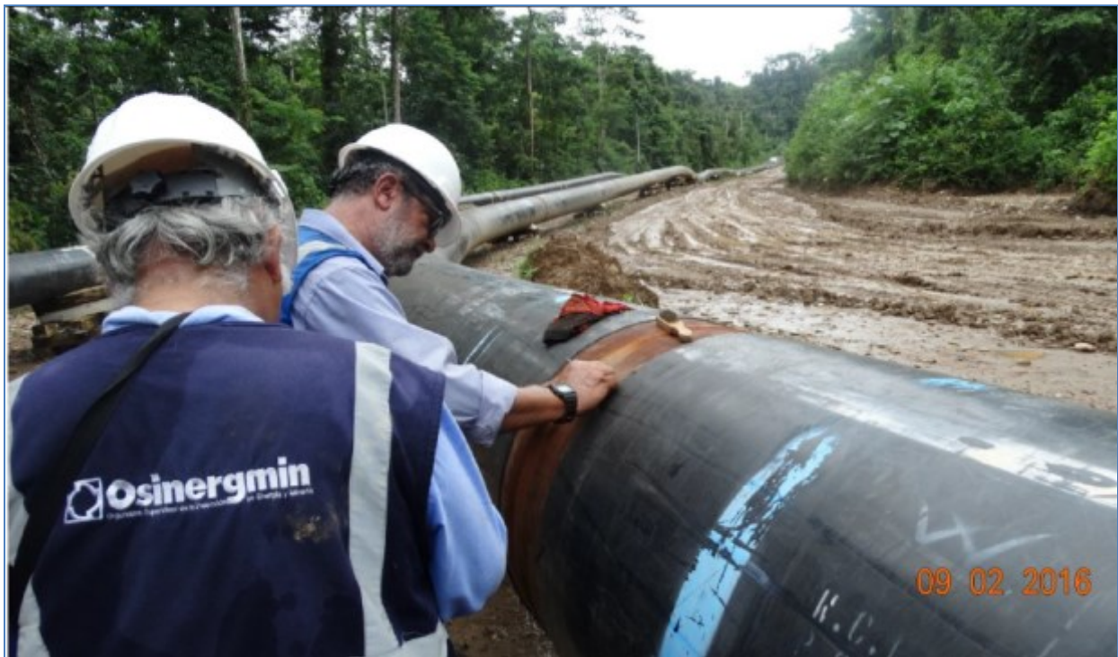
Segmento 01 del Tramo B. Inspección visual en junta del ducto de 32"Ø.
