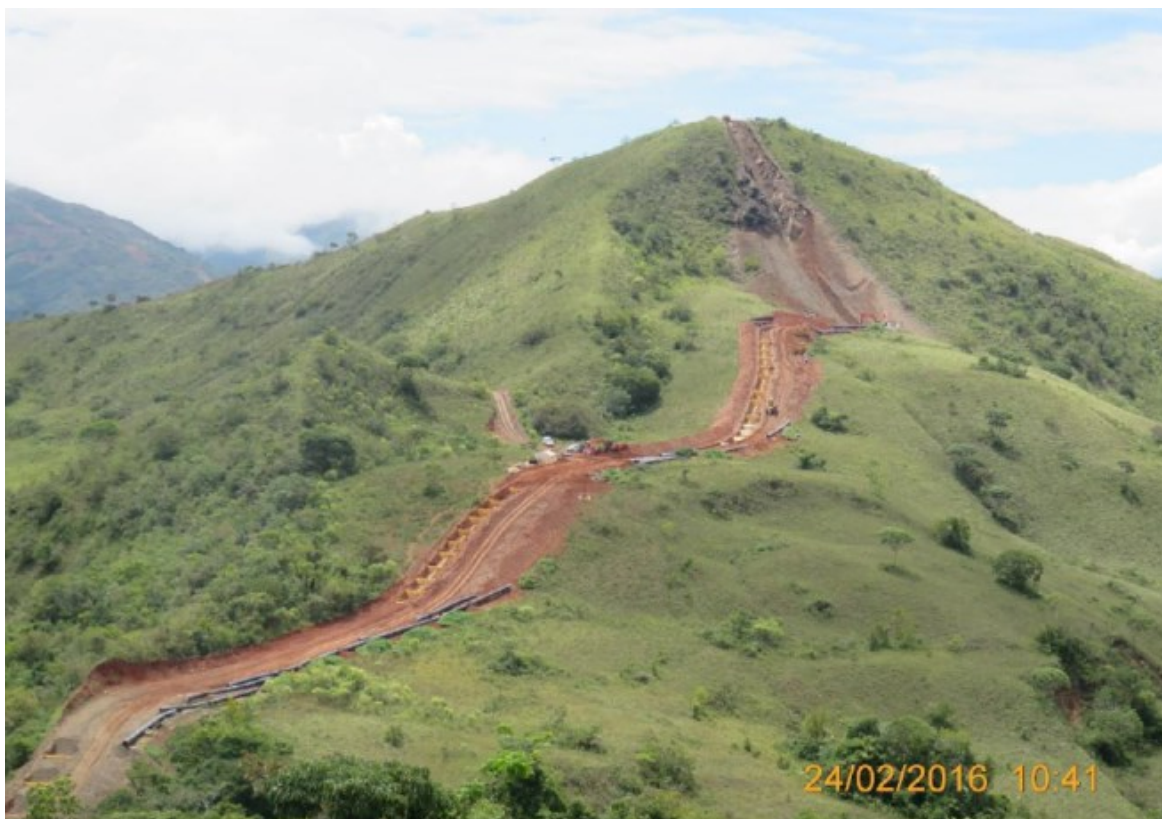
Segmento 03 del Tramo A1. Panorámica del DDV entre las progresivas KP 134+000 y KP 134+300 donde se observan diques con poliuretano en zanja.
