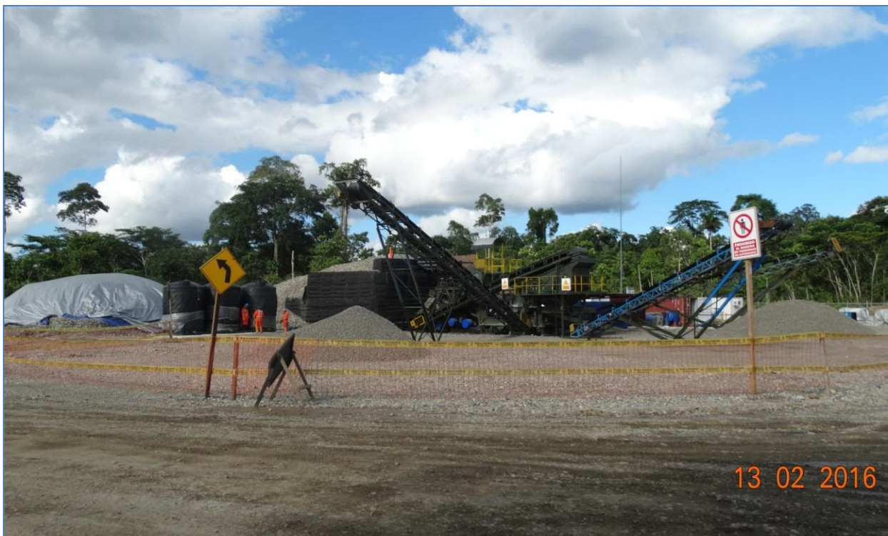
Máquina chancadora a utilizar para las obras civiles necesarias para la construcción de la Planta Compresora de Ticumpinia.
