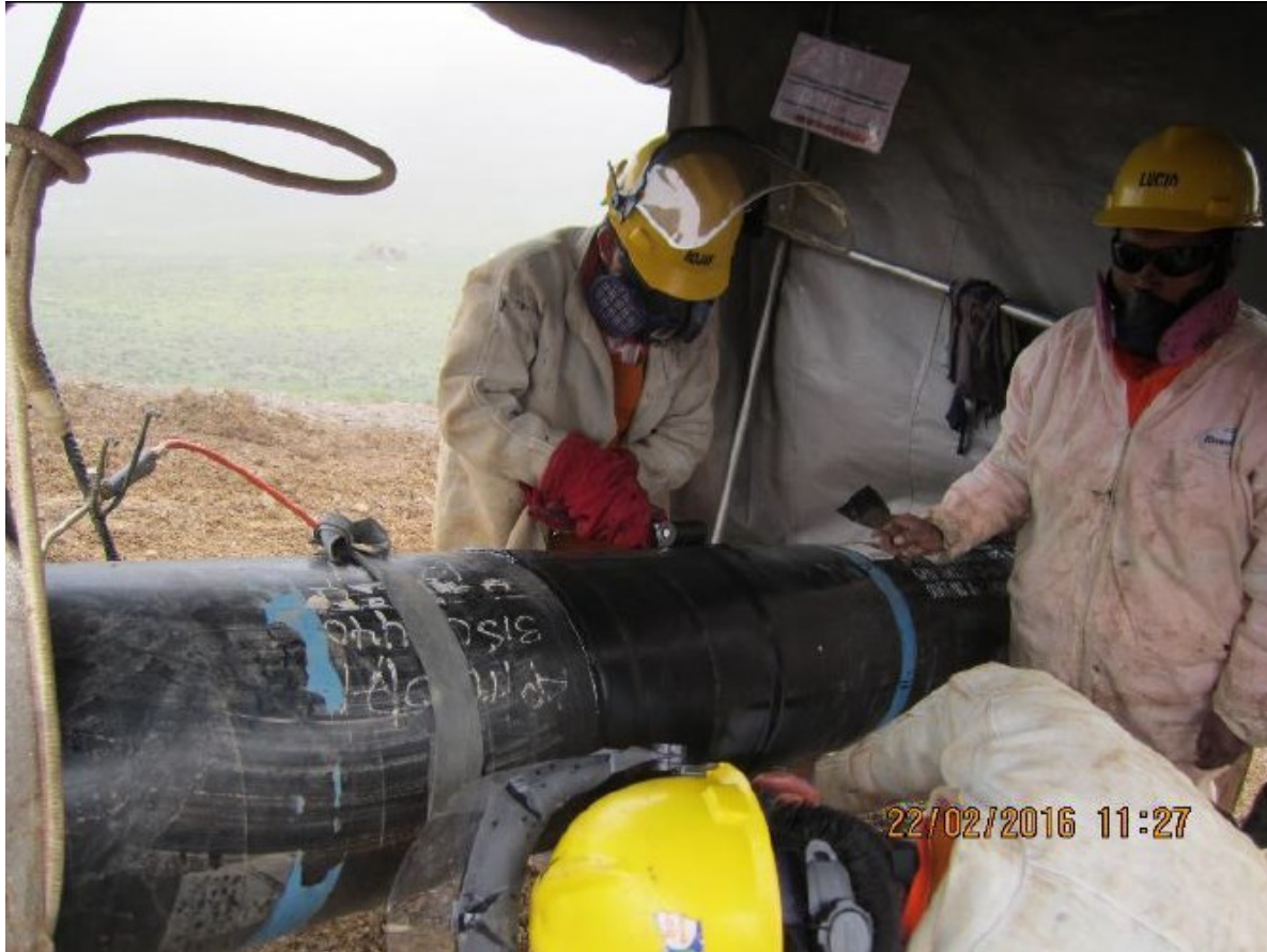
KP-000+840 del Gasoducto Secundario Cusco Anta. Instantes de colocación de manta termo-contráible sobre la superficie de la junta soldada.
