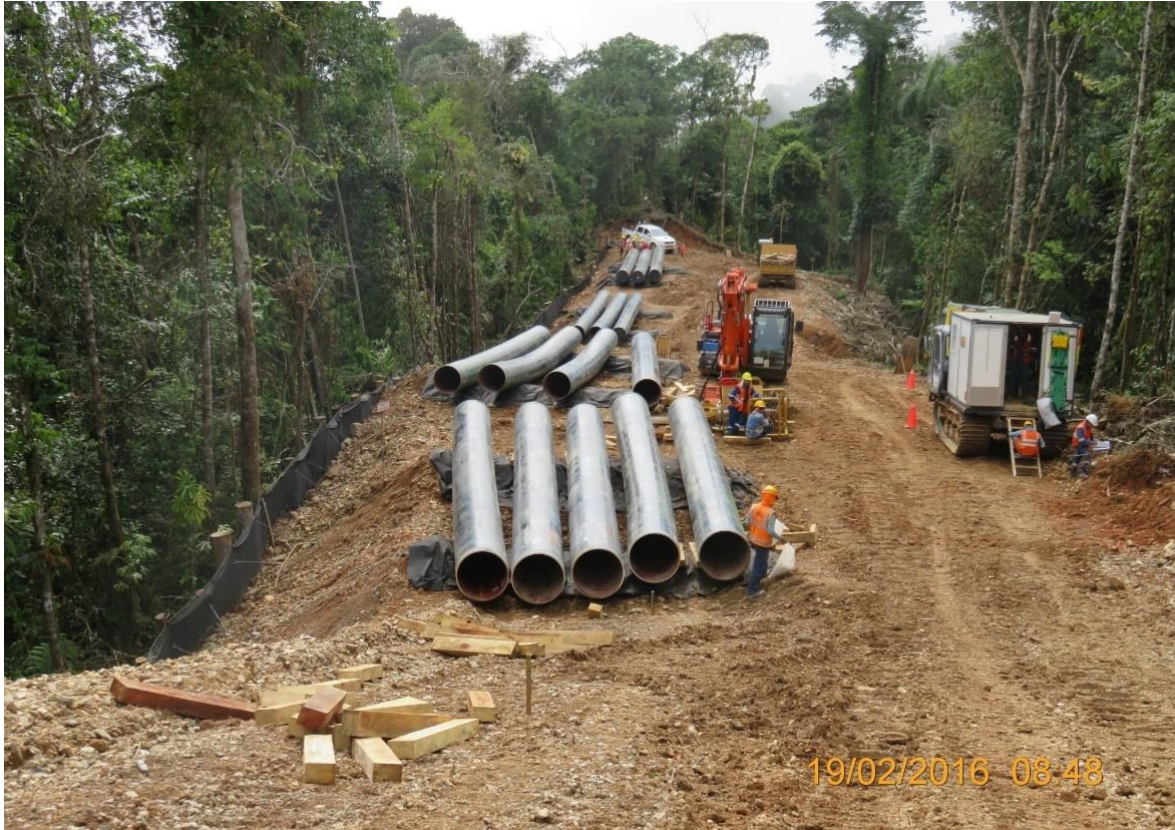
Segmento 03 del Tramo A1, KP-0093+400. Tuberías de 32"Ø dispuestas a lo largo del DdV. A la izquierda, trinchos de contención instalados como obras de control de erosión.
