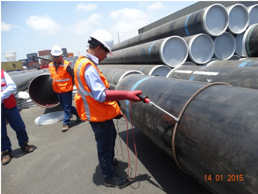
Foto-6: Supervisor de calidad de SGS verificando el estado de revestimiento con instrumento holiday debidamente certificado y calibrado
