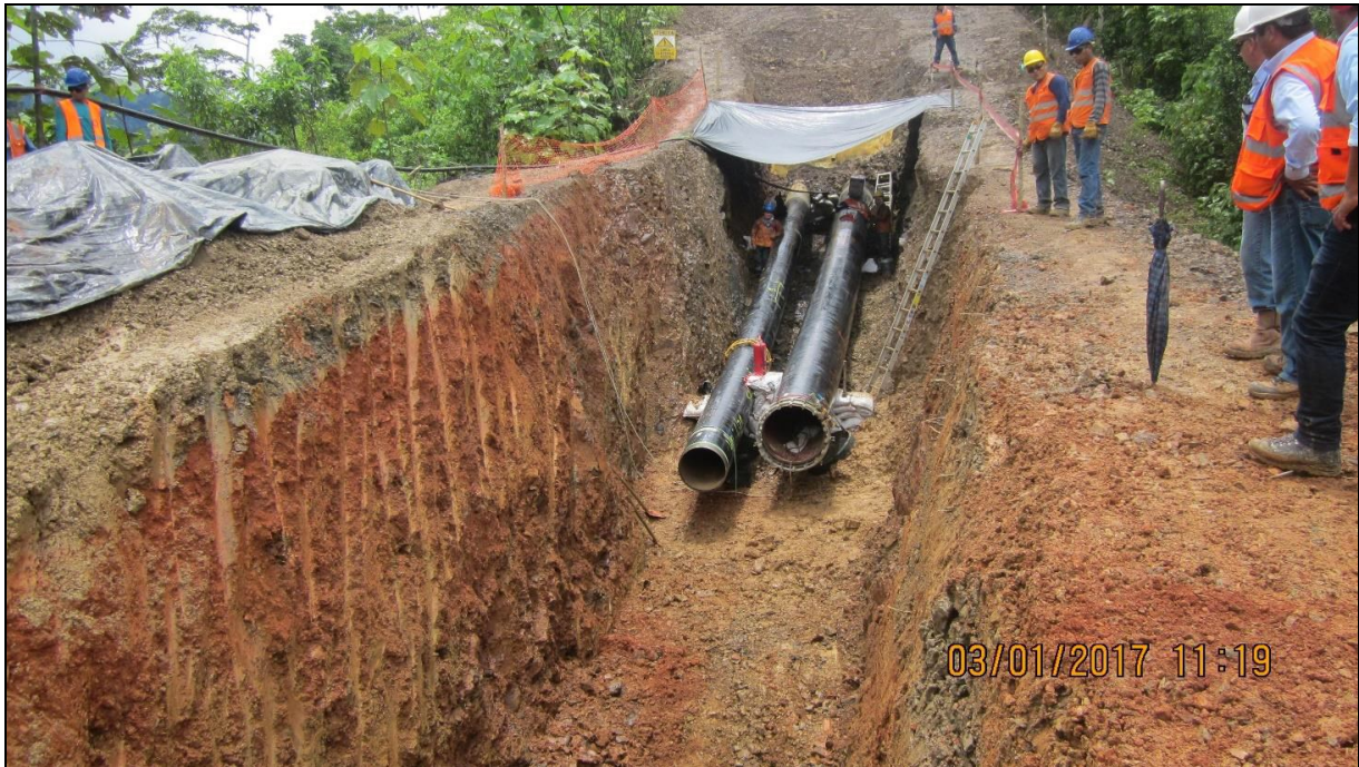
Tramo B - Segmento 2, KP 76+950 Vista de los ductos de GN y LGN dispuestos en zanja.
