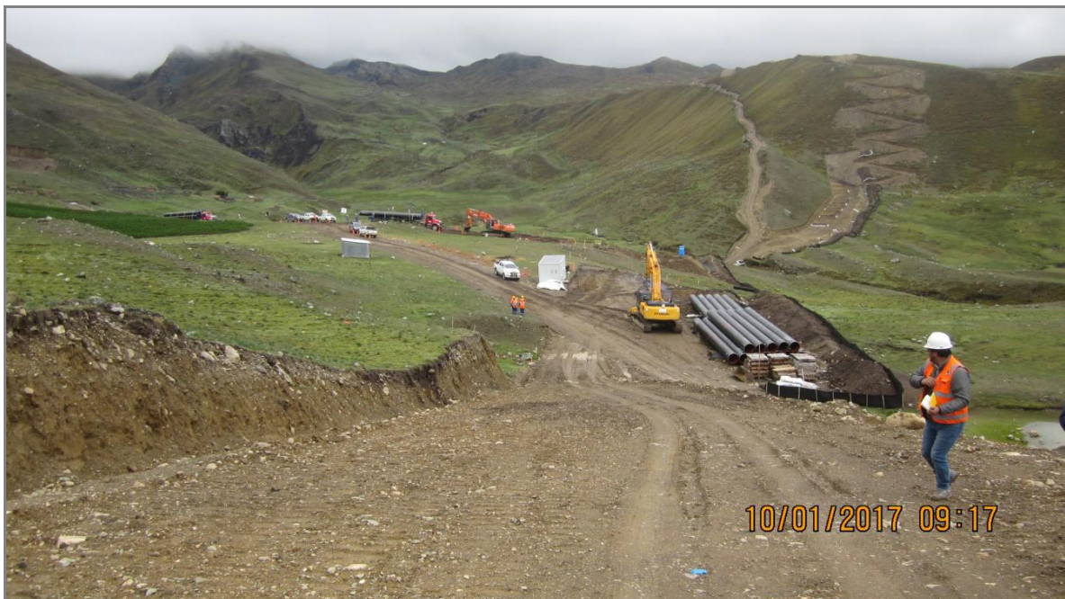
Tramo A1 – Segmento 5, KP 296+750 Transporte de tubos y acopio en el Derecho de Vía.
