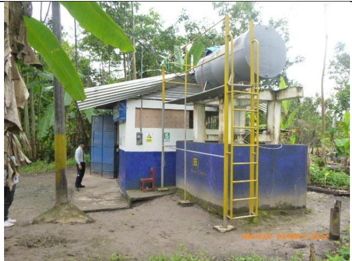
Casa de máquinas
