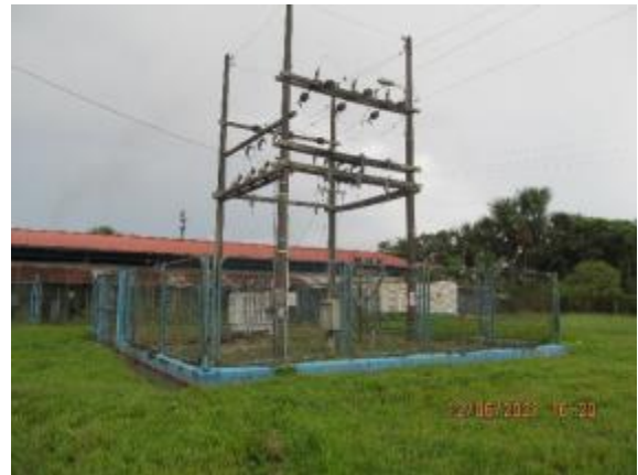
Casa de máquinas
