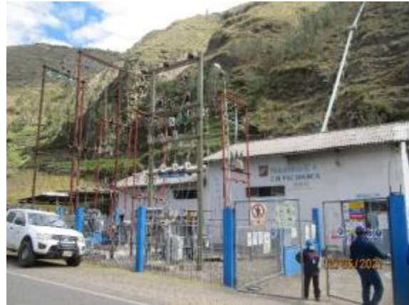
Casa de máquinas
