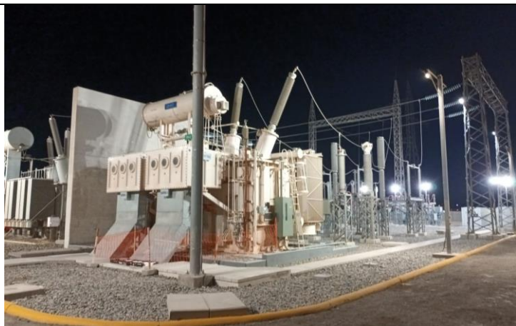
Energización de Transformador de Potencia TR-2 - SE Flamenco
