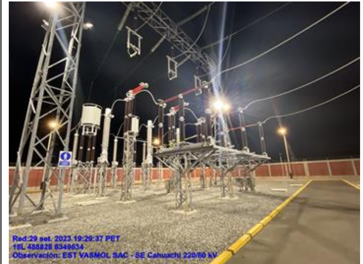
Seccionador de Línea de la L-2312 cerrado
