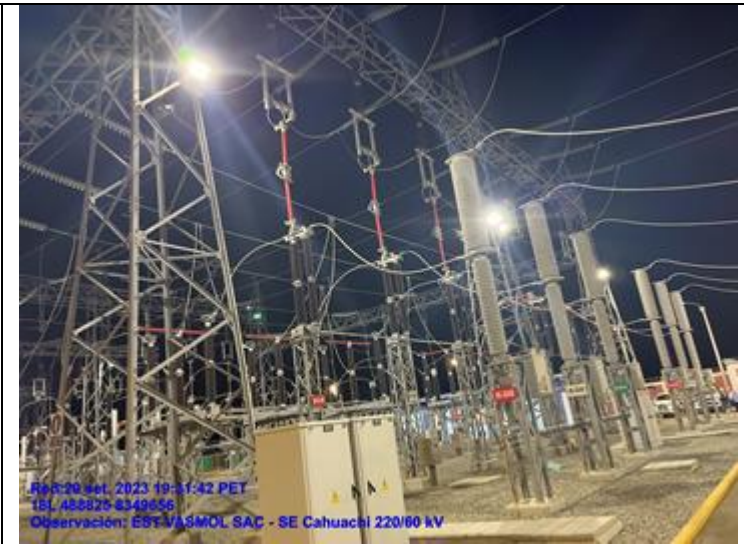
Seccionador de barra de la L-2312 cerrado
