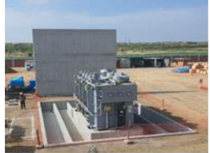
Llegada del Transformador de Potencia
