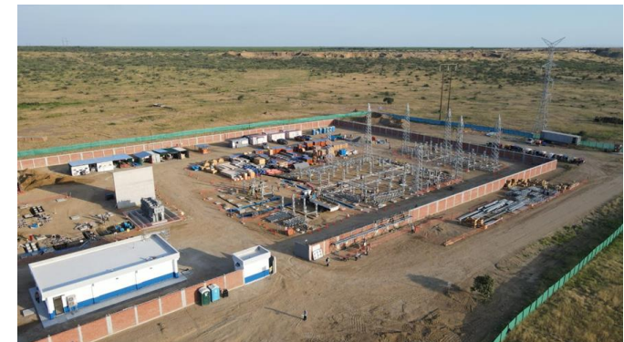
Vista panorámica del avance de obras en la S.E. Valle del Chira
