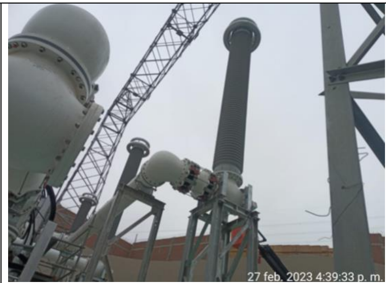
Montaje de los Bushing correspondiente a la celda de salida de Chilca
