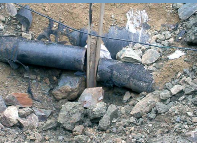
Rotura del ducto de 14 pulgadas en el KP 200+700, Banca de Toccate
