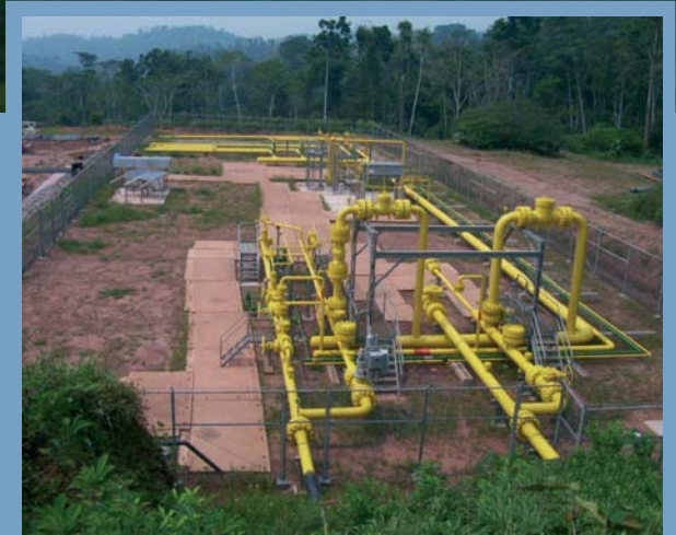
Pozos de producción de gas natural, San Martín 3, Cusco.
