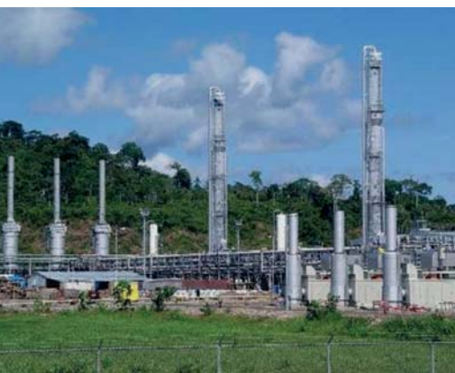
Planta de separación criogénica en Malvinas (Cusco).
