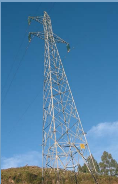
Torre de línea de transmisión de alta tensión.
