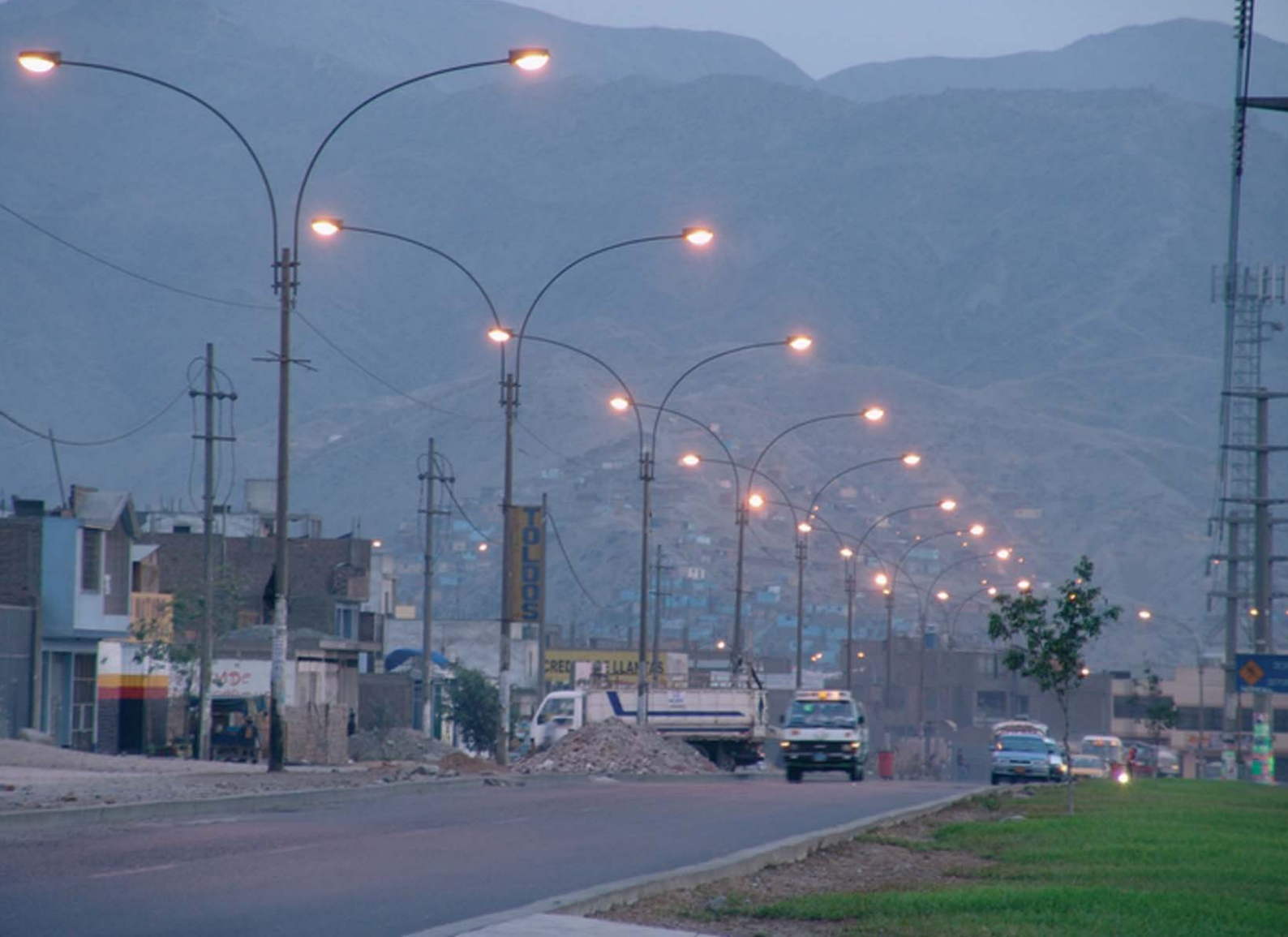
Iluminación en vía pública, Lima.
