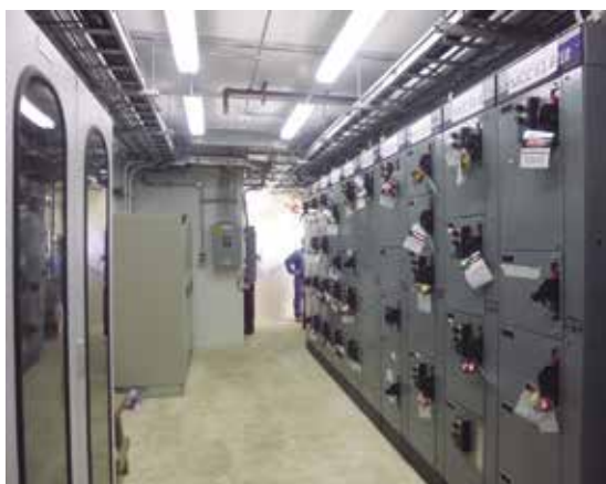
Vista del Interior del Shelter del Proyecto EPC-23 terminado y energizado.
