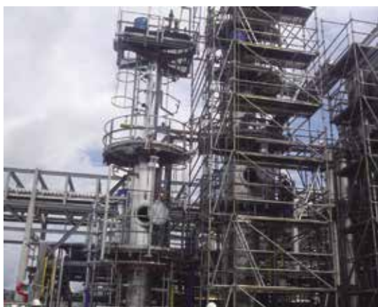
Vista muestra del Stripper y de la columna topping (a la derecha) del cual presenta el aislamiento térmico completamente instalado.
