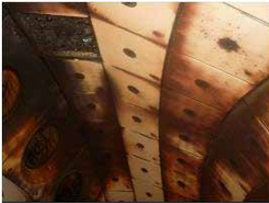
Vista de la parte superior de la cámara de combustión de la unidad TG4
