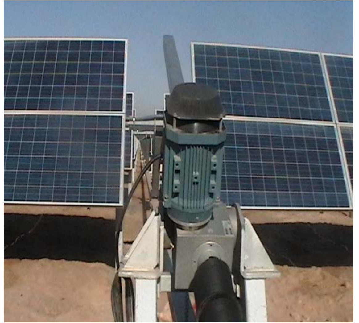
Vista del seguidor solar y módulos fotovoltaicos
