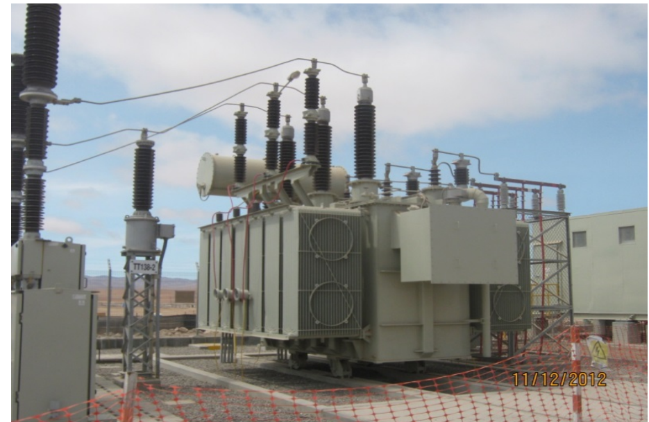
Transformador de potencia 40 MVA
