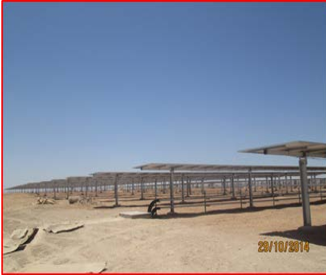
Vista del emplazamiento de los módulos Central Solar Moquegua FV
