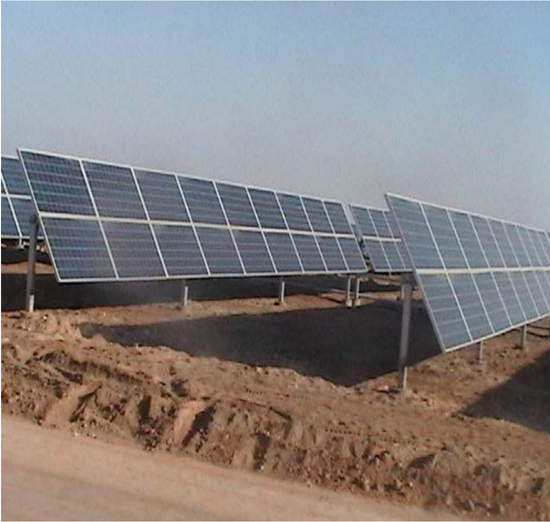
Vista del emplazamiento de los módulos
