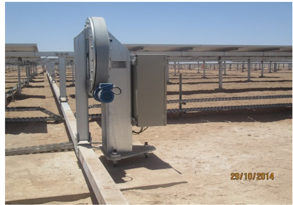
Sistema de seguimiento solar
