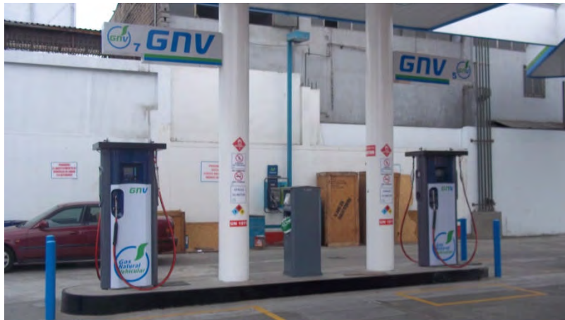
Dispensadores de despacho de GNV
