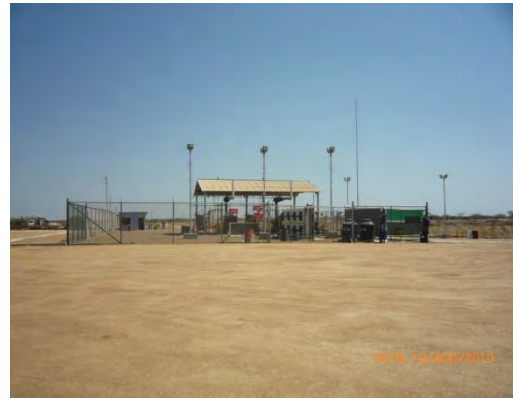
Estación de Compresión
