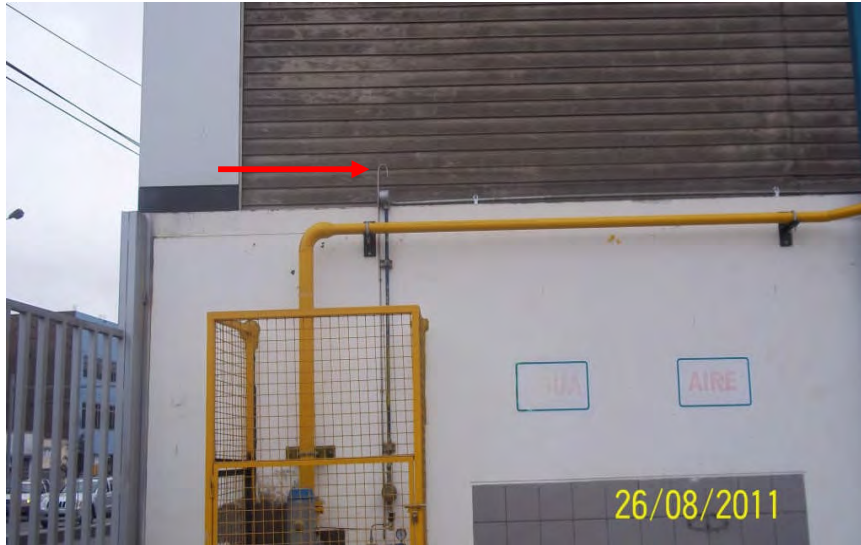
Venteo de válvula automática
